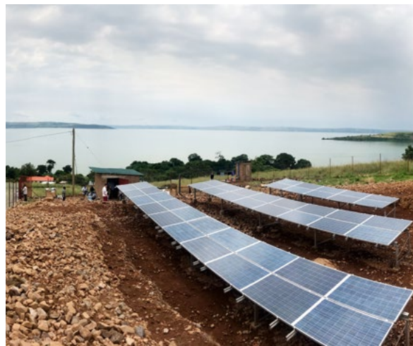
Demonstrationsanlage für Second Life-Batterien auf der Insel Kibumba, Tansania.
